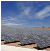
メガソーラー Mega solar
